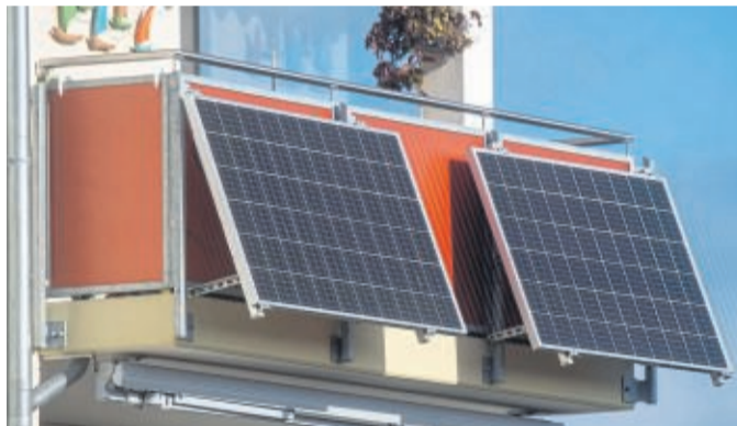
Solarmodule für ein Balkonkraftwerk: Anlagen, wie auf diesem Symbolfoto aus Stralsund kann sich die CDU auch in Battenberg vorstellen. FOTO: STEFAN SAUER/DPA
